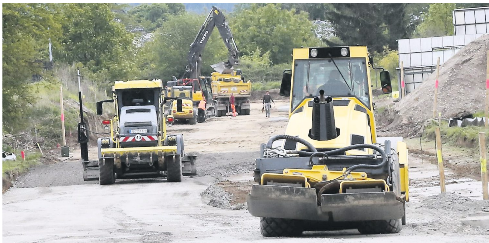
Im Dezember 2019 hat die Erschließung des Gewerbegebiets Nord (gegenüber des Hauptfriedhofs) begonnen. Die Arbeiten laufen aktuell auf Hochtouren. Möglichst noch vor der Sommerpause soll der Weinheimer Gemeinderat entscheiden, welche Firmen sich dort ansiedeln können.
